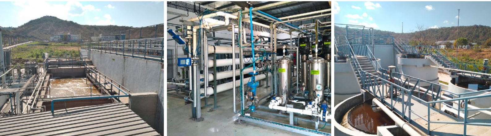
Figure 2 : Station SUFRO® de 8,3 m 3 /h près de Mumbai, Inde – épuration biologique (gauche) osmose inverse (centre) décanteur secondaire et cuve d’ultrafiltration (droite)
