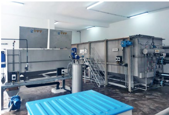
Figure 1 : Installé pour gagner de la place – Flomar® Flottation pour le prétraitement des eaux usées et extrudeuse pour la déshydratation des boues dans une usine de poisson au Maroc
