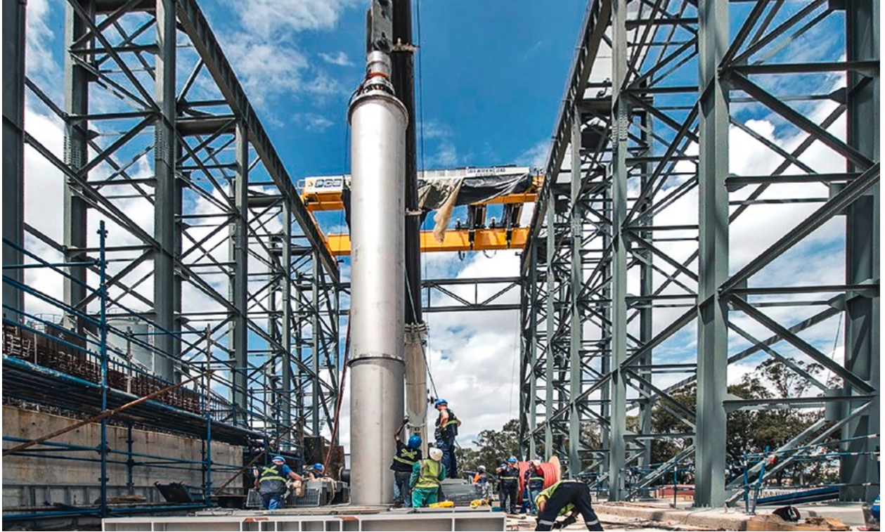
Figure 2 : Installation d'une des pompes ANDRITZ
