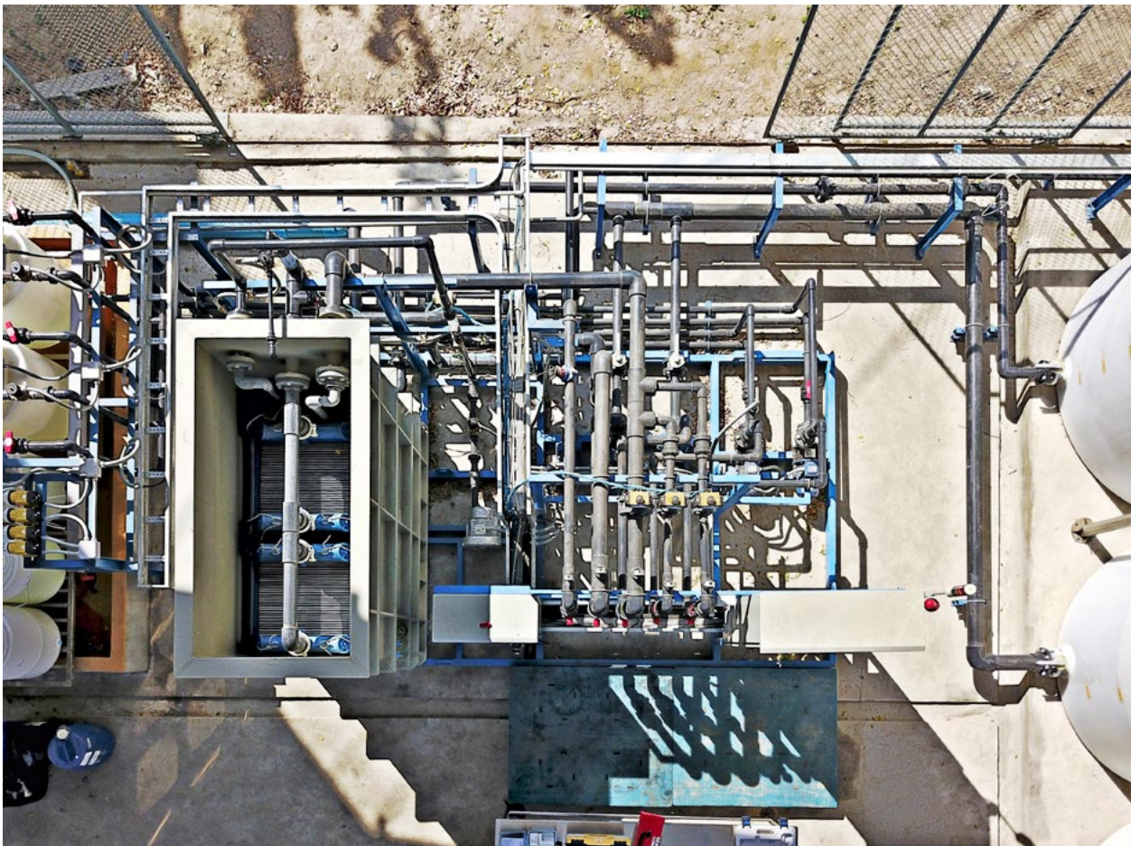
Figure 2 : Photographie de l'installation Cerafiltec intégrée
