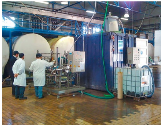
Figure 1 : Système mobile AQUATECTOR® Microfloat® pour le traitement saisonnier des eaux usées de la transformation d'olives en tant que projets pilotes au Liban, en Syrie et en Jordanie
