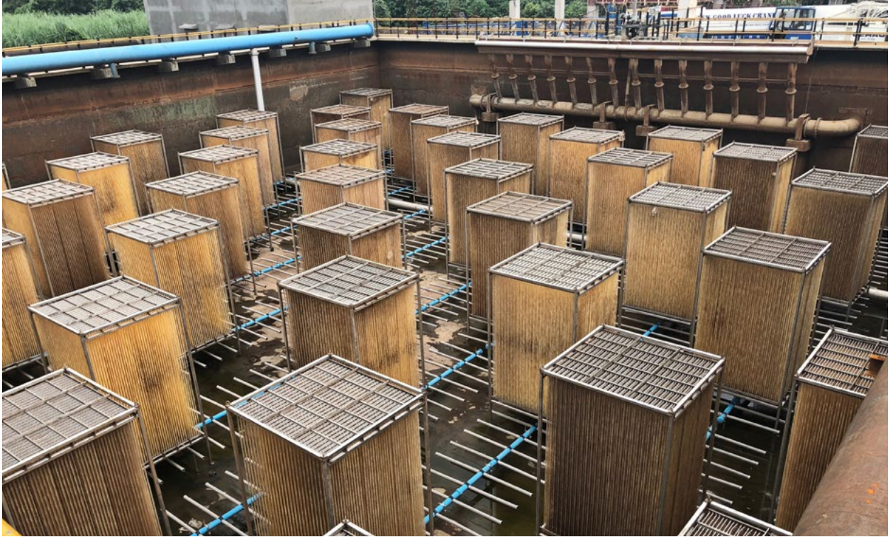
Figure 1 : Un des six bassins SBR avec cages Biocurlz et aérateurs à tubes à fines bulles
